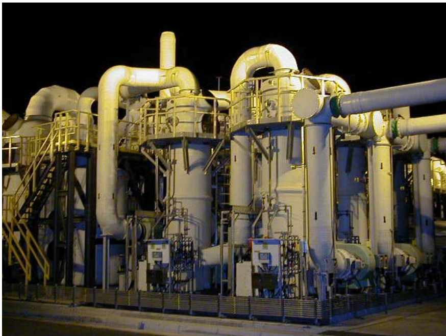
Die Kombination verschiedener Technologien zur Geruchsbeseitigung ermöglicht hocheffiziente Gesamtlösungen.
